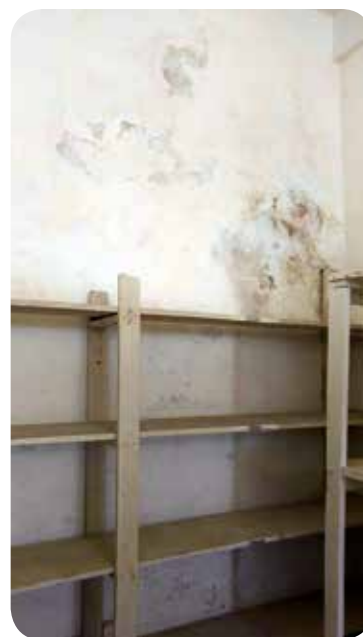
Figura 3: Paredes com manchas de mofo.
