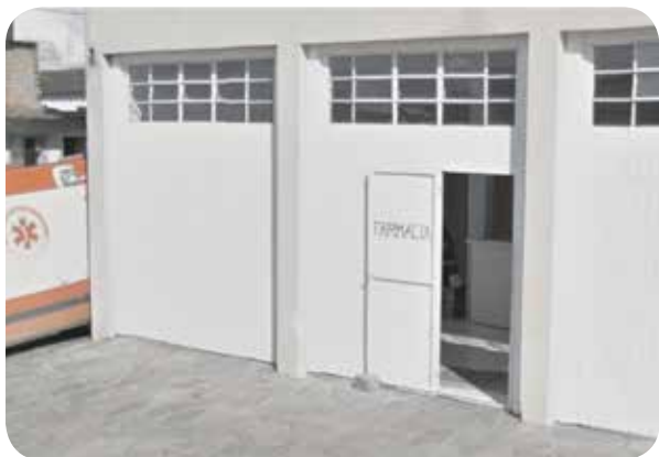
Figura 1: Portões de entrada da Farmácia Municipal de Canguçu antes da reestruturação.
